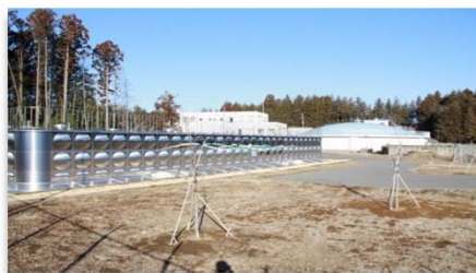
水道局の貯水タンク
