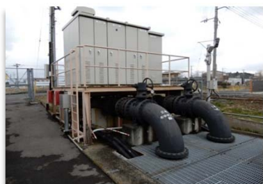
更新される排水施設ポンプ
